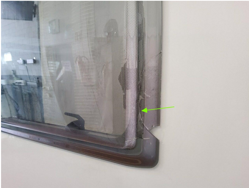
Bild 17 : Aufbauseite links, Seitenfenster gebrochen
